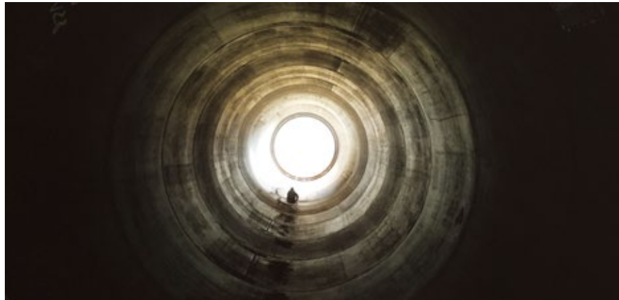
Interior de torre eólica.
