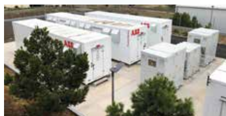
Lado sul da central de baterias
