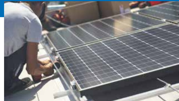
Instalações de equipamentos Aquarea de Panasonic e painéis solares
