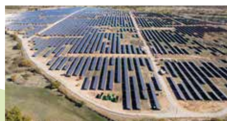
Projeto Solar PV em Mogadouro
