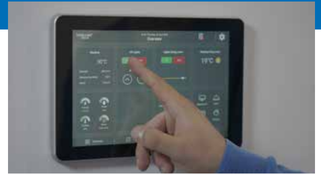
Controle centralizado para ar condicionado, luzes, persianas e opções de segurança
