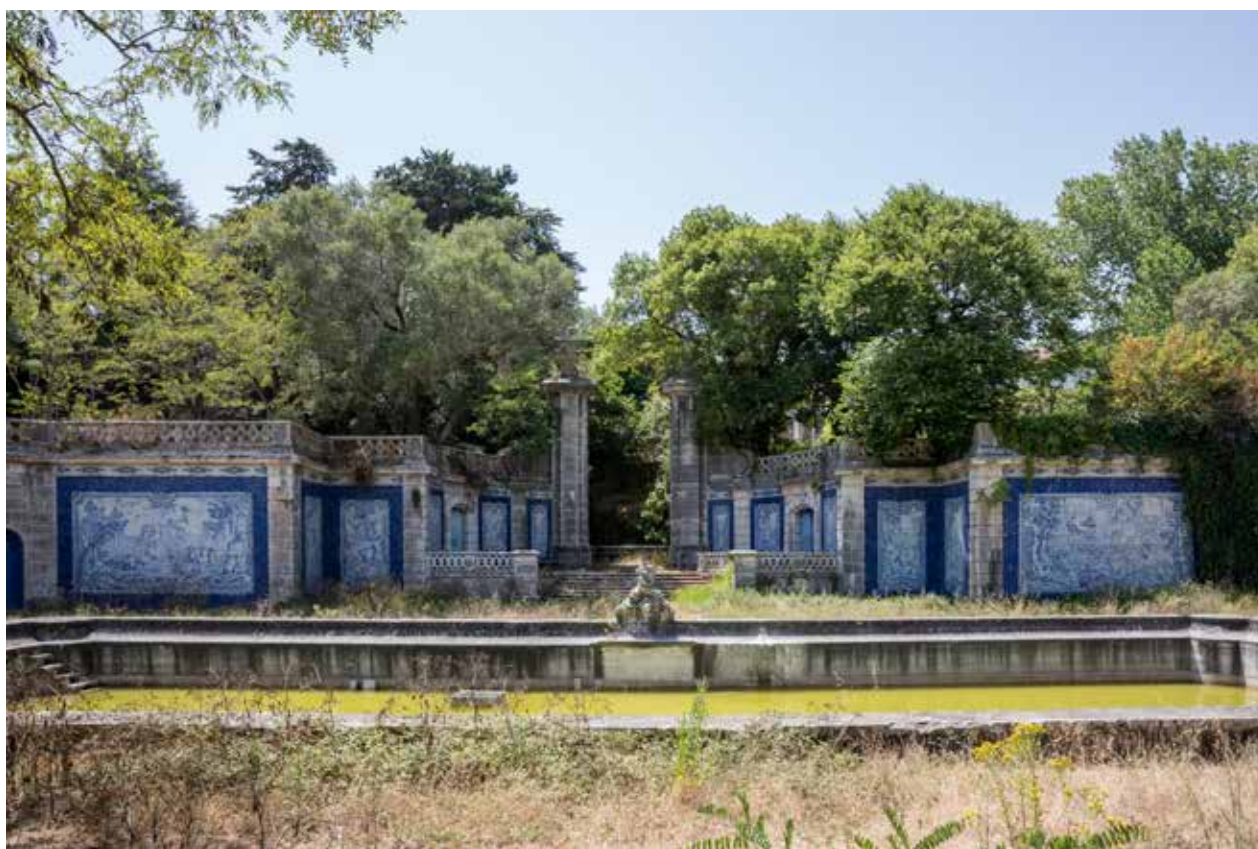
A Cascata da Casa da Pesca e o Tanque da Pesca com os painéis de azulejo, zona em degradação
